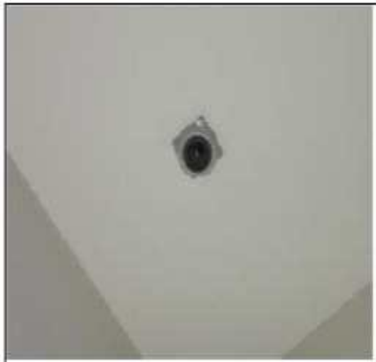
내부 출입문 CCTV사진
