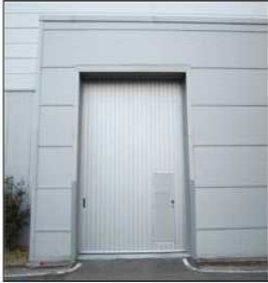
시험실 외부 Steel sutter 출입문
